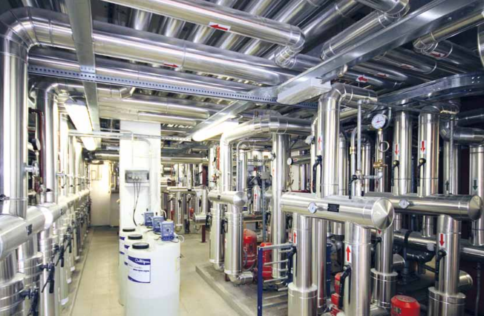
PARTICOLARI D'INSIEME Centrale termofrigorifera Special Detailed Installations.
