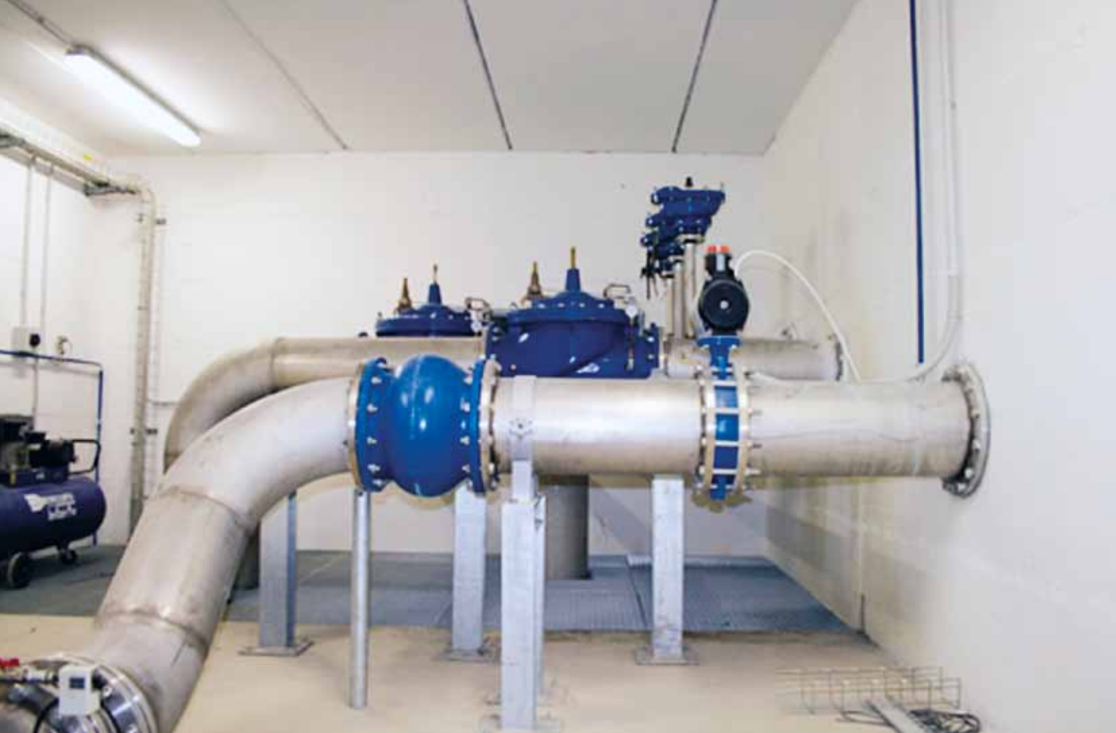
PARTICOLARI D'INSIEME Stazione di spinta. Special Detailed Installations.
